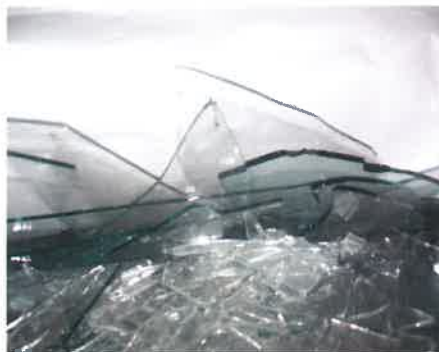
Rotura de un vidrio recocido
